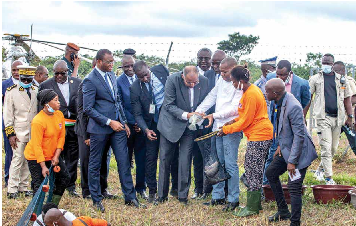
Le Premier ministre a procédé à la pose de la première pierre et à la visite du chantier.
